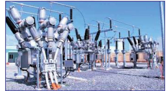
Trạm biến áp không người trực 110kV ENT: Hiện đại, ngầm hóa và được điều khiển từ xa
