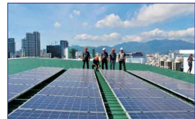
Hệ thống ĐMTMN trên tầng 13 công ty CPĐLKH
