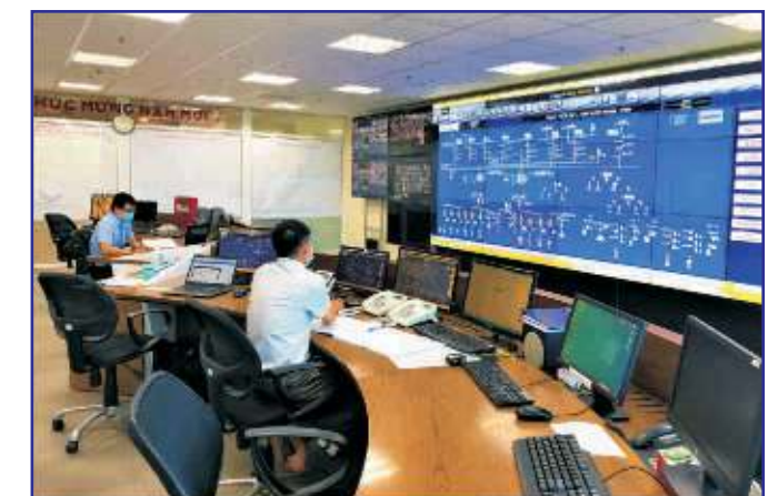
Trung tâm Điều độ quản lý hệ thống lưới điện Khánh Hòa
