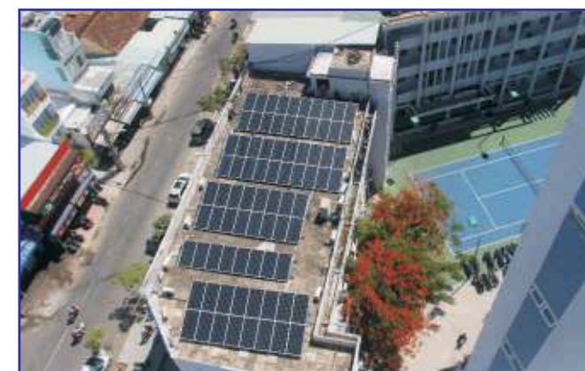
Hệ thống ĐMTMN trên tòa nhà B3 của công ty CPĐLKH
