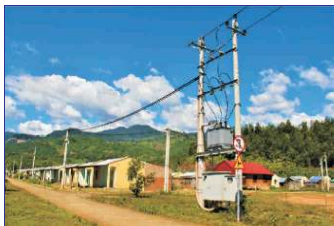
Hoàn thành Hệ thống RF-Spider tại Thôn Bồ Lang - Khánh Vĩnh
