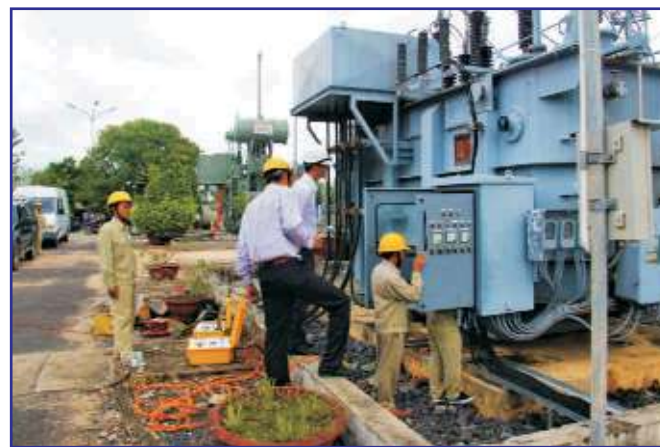
Thí nghiệm và kiểm tra các thông số Trạm biến áp 110kV (Diên Khánh)
