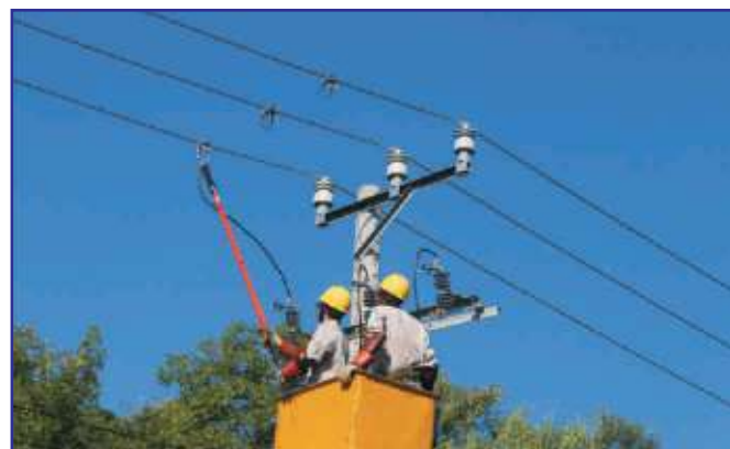
Thi công Hotline (Lắp lem kẹp) trên lưới điện trung áp đang mang điện
