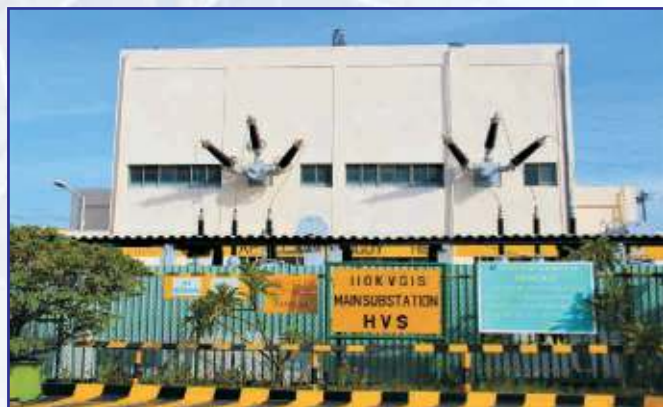
02 TBA 110kV với tổng công suất: 41 MW tại Nhà máy đóng tàu Hyundai Vinashin (nhìn từ bên ngoài)
